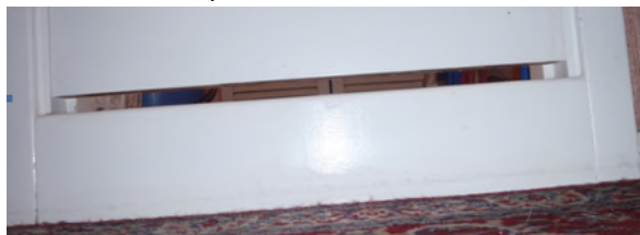
Dør til bad med høy terskel og 2-3 cm luftespalte
